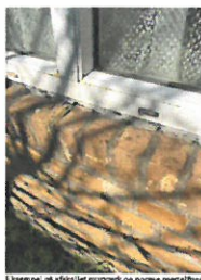
Eksempel på afskallet murværk og porøse mørtelfuger både ved væg og stålbænk ved nr. 25.
