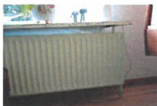
Nr. 38 læst tapet bag radiator hvor væg er oplyst.
