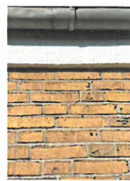
Eksempel på revner i mørtelfuge og frøsprængt støn ved nr. 20.
