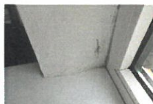
Nr. 36 - Eksempel på synlig skimmel i vinduesytring i søvneværelse.
