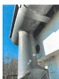
Eksempel på tagrende og nedløb ved nr. 43.
