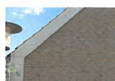
Eksempel på skader i murværk i gavl.
