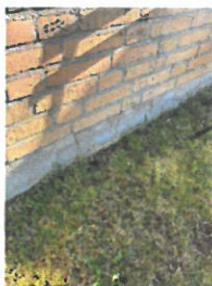
Eksempel på revner i vækkel ved nr. 4.
