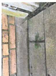
Eksempel på revner og afskallet puds ved nr. 2.
