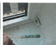
Nr. 34 - Eksempel på synlig skimmel i vinduesytring i søvneværelse. Prøven er analyseret til kategori C (se bilag 2)
