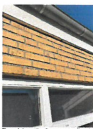
Eksempel på revnet liggefuge over stønoverlag i nr. 17.
