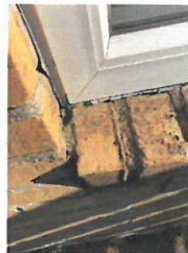
Eksempel på revnede/kraklerede elastiske fuger ved nr. 2
