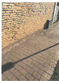
Eksempel på revner i vækkel ved nr. 17.
