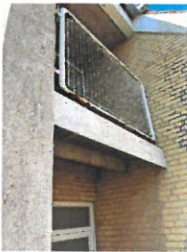
Eksempel på rustnede bjælker og røstværk ved nr. 13
