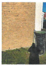
Eksempel på tabte murstuds i gavl ved nr. 18.
