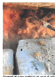
Eksempel på rustne murbinder på grund af opløst murværk ved gavl ved nr. 1.
