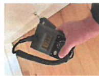
Nr. 22 Eksempel på fugtmåling i skimmelig pålevæg efter skimmelse og forsøg på udrensning.
