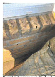
Eksempel på frøsprængt murstålbenk med øje i nr. 7.
