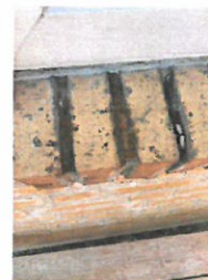
Eksempel på revnede/kraklerede elastiske fuger ved nr. 47
