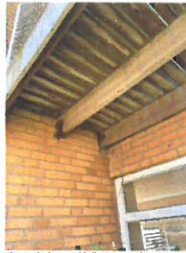
Eksempel på rustne bjælker og opfugtet mureværk ved nr. 14
