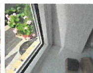
Nr. 54 - Eksempel på synlig skimmel i vinduesytring i søvneværelse.
