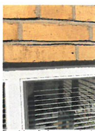
Eksempel på revnet liggefuge over stønoverlag i nr. 23.
