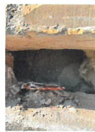
Restangbrøst murbinder i gavl ved nr. 22 grunder opløst murværk.
