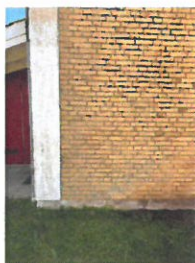
Eksempel på revner i vækkel ved nr. 22.
